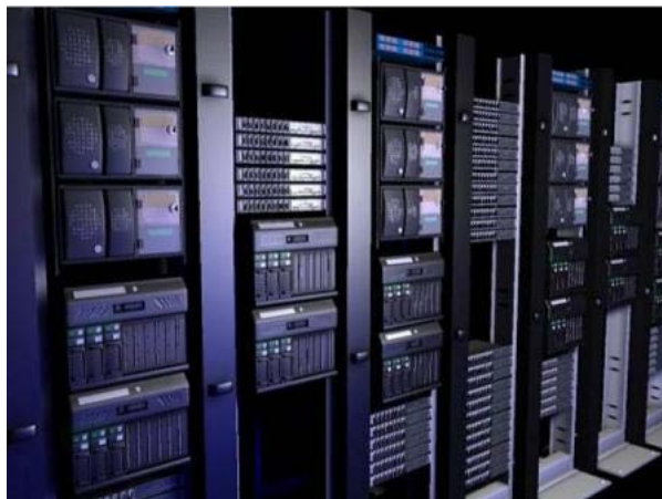
Figure 1 : Armoires de serveurs dans un datacenter
